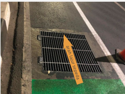
Alur grating manhole utilitas yang sejajar jalur sepeda dan sempit menimbulkan kecelakaan seorang pesepeda
