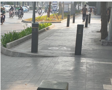
Jalur sepeda trotoar yang terpotong oleh ramp pada inrit bangunan
