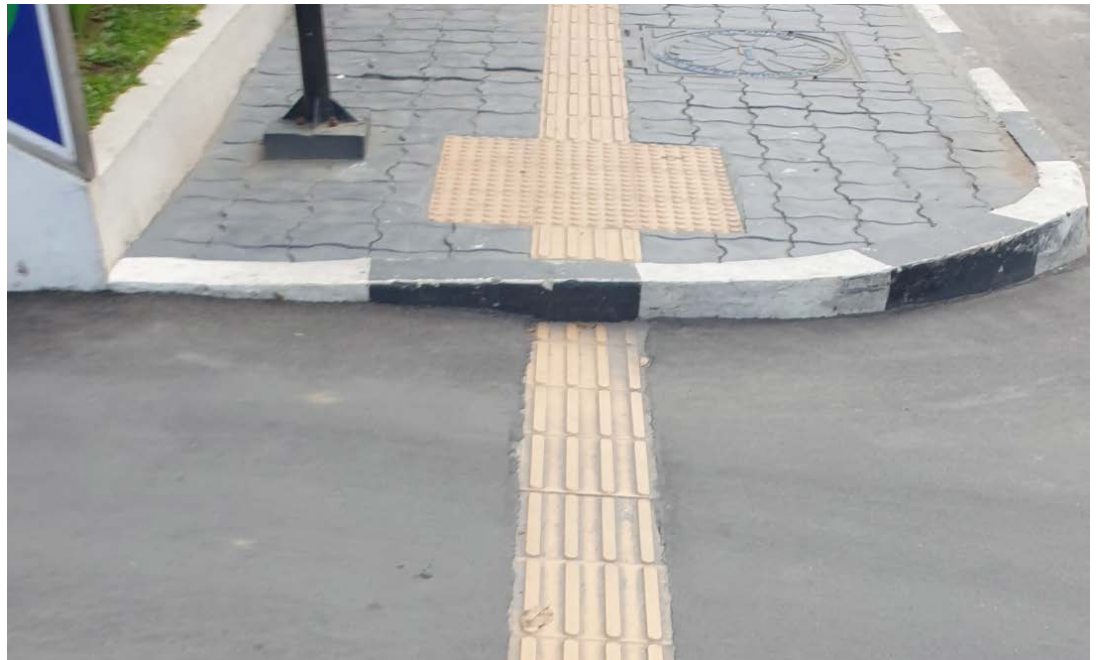
Jalur pemandu yang terputus pada pintu masuk bangunan Bank Mandiri, Jalan Pulau Pinang
