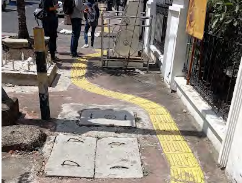
Gambar 72. Jalur pemandu yang berkelok menghindari manhole utilitas di Jalan Balai Kota
