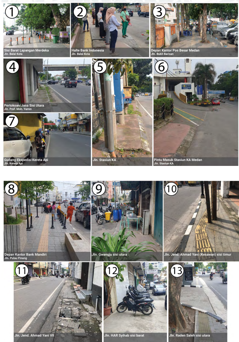
Gambar 67. Dokumentasi kondisi trotoar di kawasan delineasi (ITDP Indonesia, 2021)
