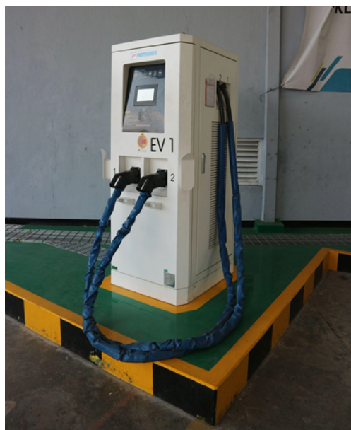
Gambar 36. Pengisi Daya Double Gun Bertipe Plug-in DC CCS2, dengan Keluaran Daya Maksimum 200 kW oleh Powerindo Prima yang Digunakan pada Depo Operator
